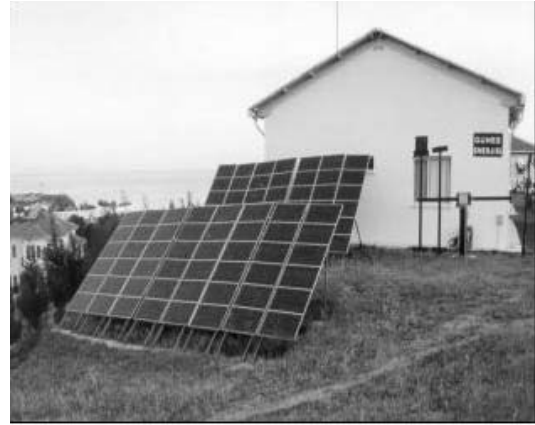
Şekil 6. 4.8 kW'lık şebeke bağlantılı güneş pili sistemi.
